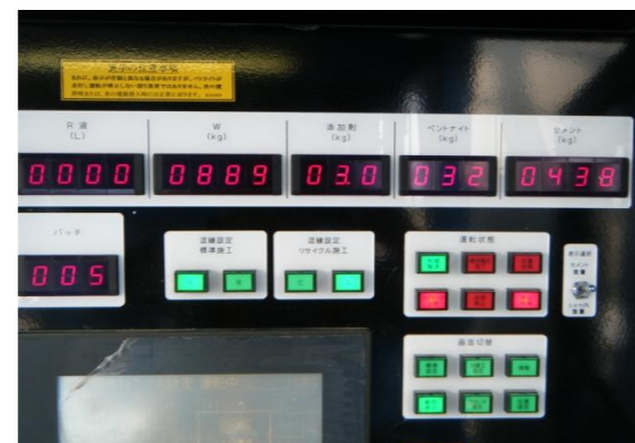
⑦GSSプラント操作盤
