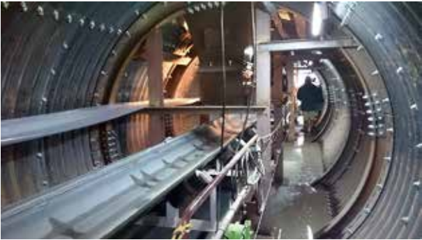
引き出しトンネル内部(設備設置後)
